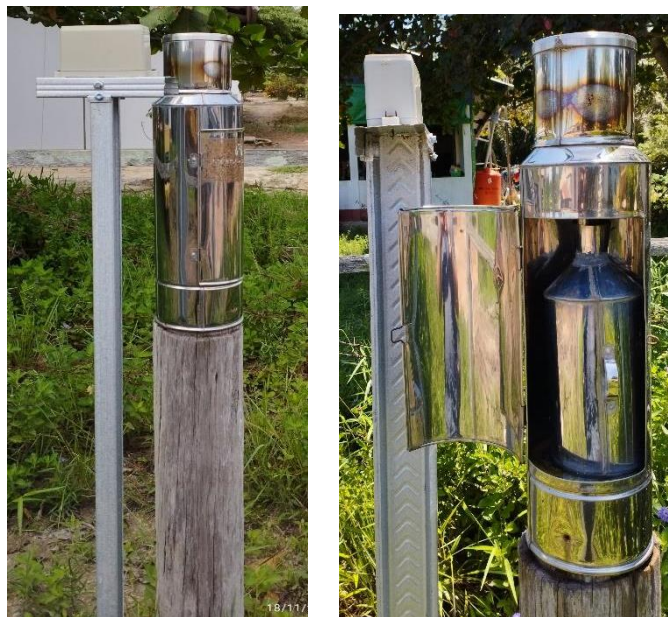
Gambar 9. Pemasangan Ombrometer OBS dan Tipping Bucket
