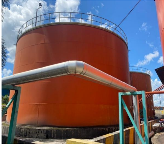
a. Tangki penyimpanan ( Storage Tank )
