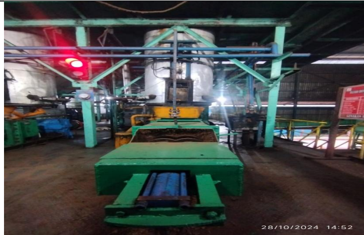
Stasiun Press & Digester
